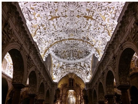
Figura 3.15. Yeserías de la bóveda de la iglesia de Santa María la Blanca.
