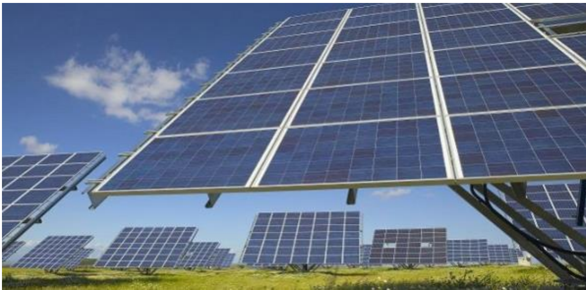
Fig. 33 Planta fotovoltaica con seguidor solar de 2 Ejes
