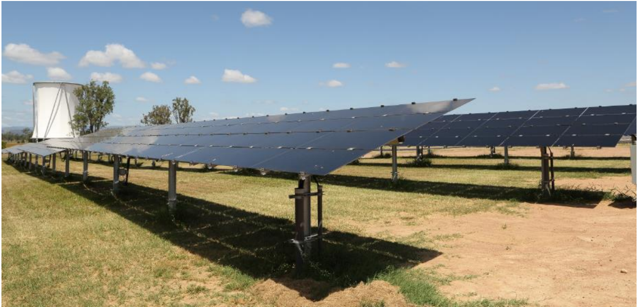
Fig. 31 Planta Fotovoltaica con Seguidores Solares de 1 Eje
