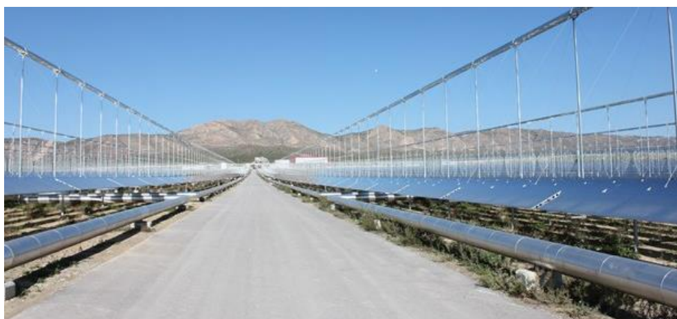
Figura 2.7. Planta Termosolar de Tecnología Fresnel (Puerto Errado). [14]
