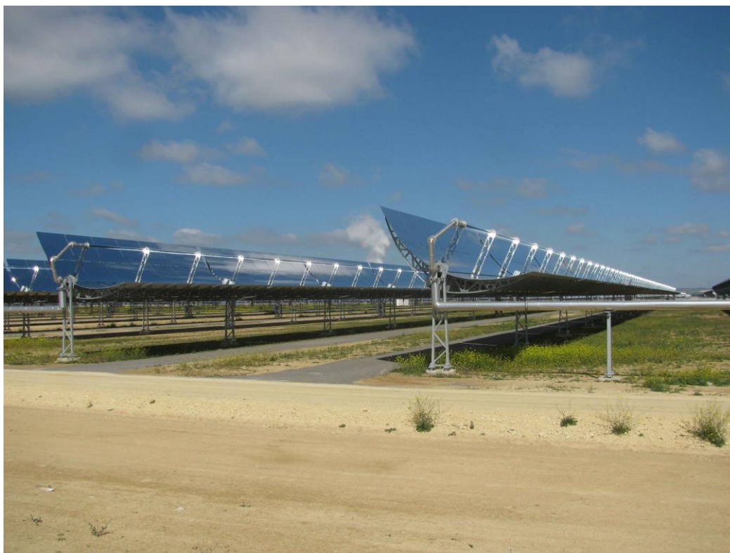
Figura 2.8. Planta Termosolar de cilindro parabólico (Valle 1 y Valle 2). [15]
