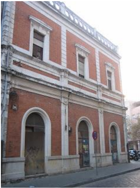
Imagen 17. Imagen donde se aprecia el estado de abandono del edificio antes de aprobar el proyecto de remodelación.
