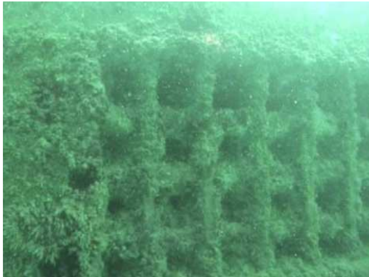
Figura 3.3 Obstrucción de las rejas por ensuciamiento (Sánchez-Barriga & Pita, 2016)
