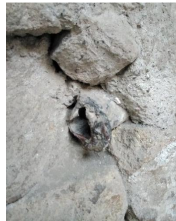
Imagen 43: [F1] Detalle. Fragmento de tubería incrustado en el muro
