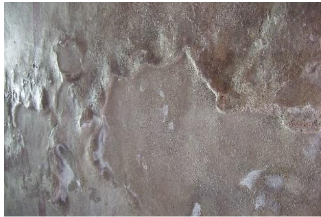
Imagen 33: [P1] Detalle. Levantamientos, abombamientos y grandes marcas de estallido del intonaco
