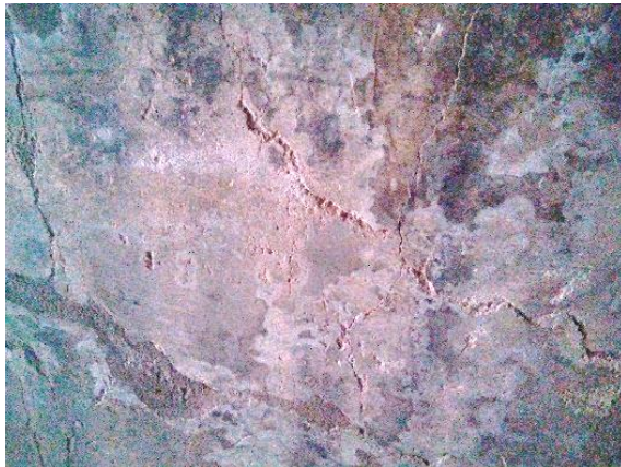
Imagen 34: [P2] Detalle. Eflorescencias salinas
