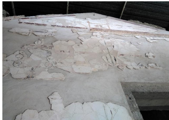
Imagen 84: [15] Detalle. Pinturas fragmentadas y reconstrucción de mortero
