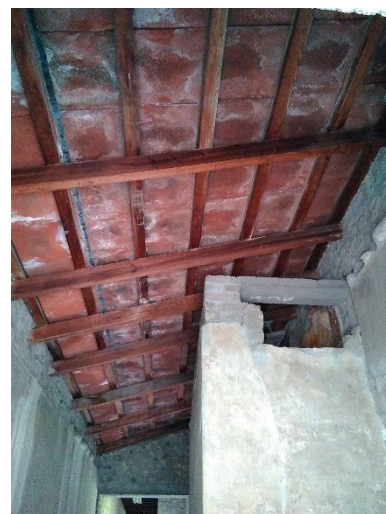
Imagen 86: [P10] Detalle. Eflorescencias salinas en el techo
