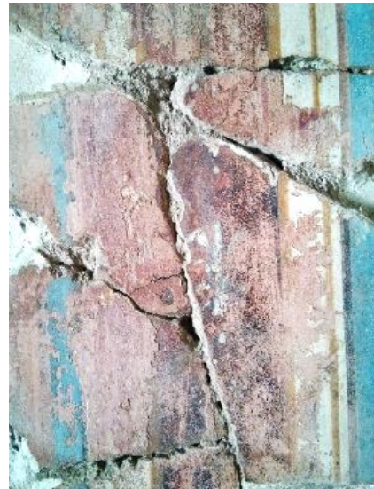
Imagen 31: [H2] Detalle. Grietas y pérdida de película pictórica
