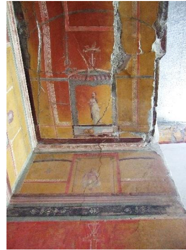
Imagen 45: [B3] Detalle. Grietas, levantamiento del mortero, alteración del color
