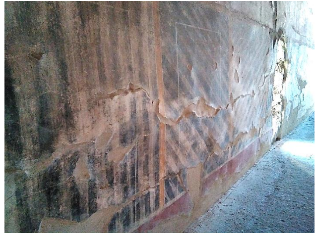
Imagen 75: [C5] Detalle. Abombamientos del muro
