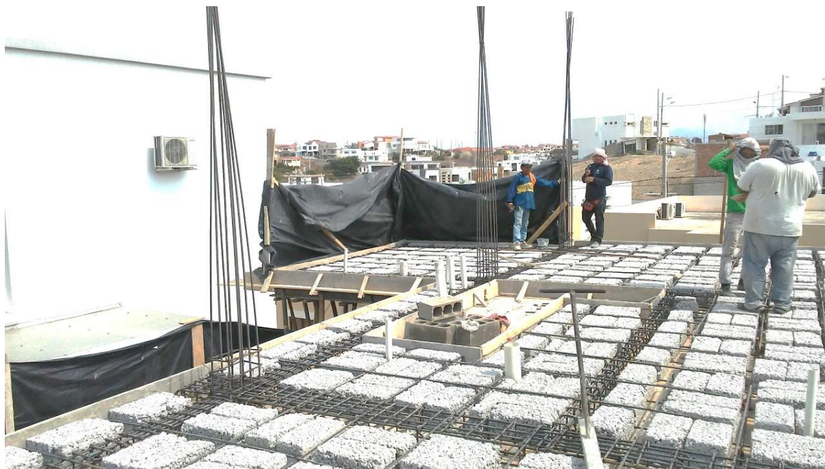
Gráfico No. 25. Colocación de bloques en los paños que conforman la losa para la segunda planta. Vivienda Familia Vélez - Moreira. (2019).
