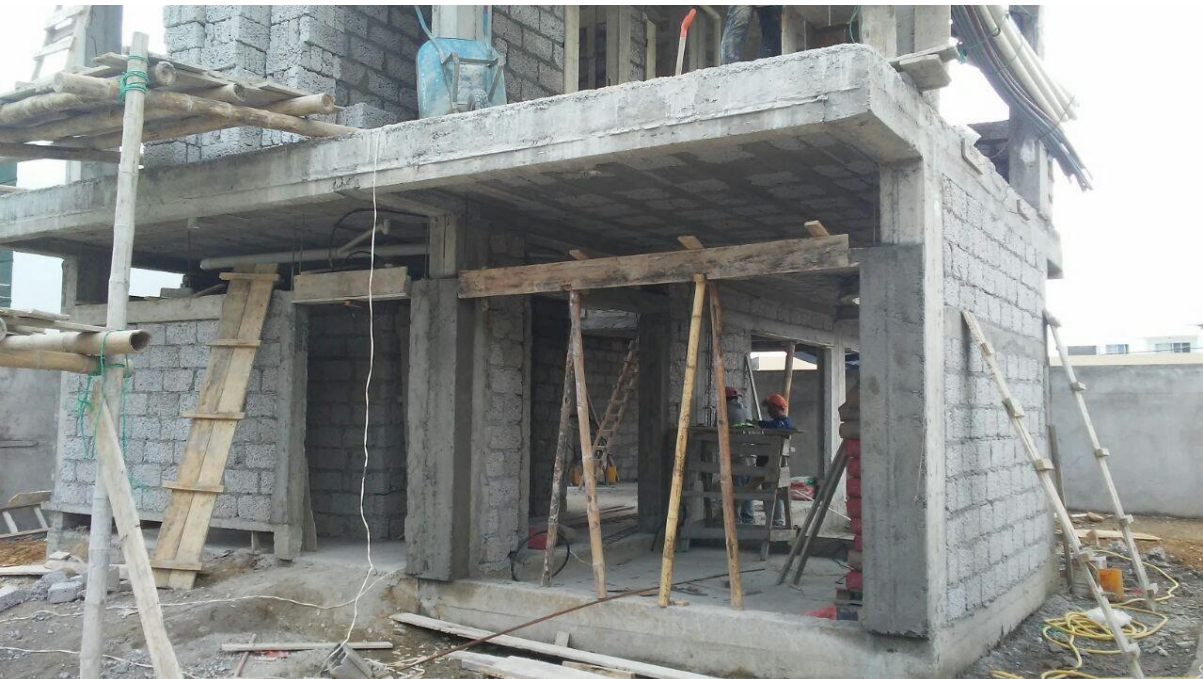
Gráfico No. 28. Colocación de paredes de bloque en ambas plantas. Vivienda Familia Vélez - Moreira. (2019).
