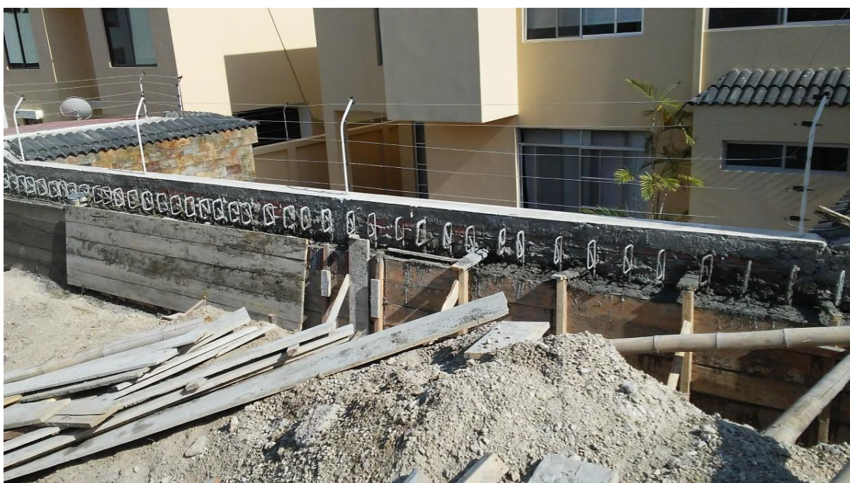
Gráfico No.22. Muros perimetrales y armado de riostras. Vivienda Familia Vélez - Moreira. (2019).
