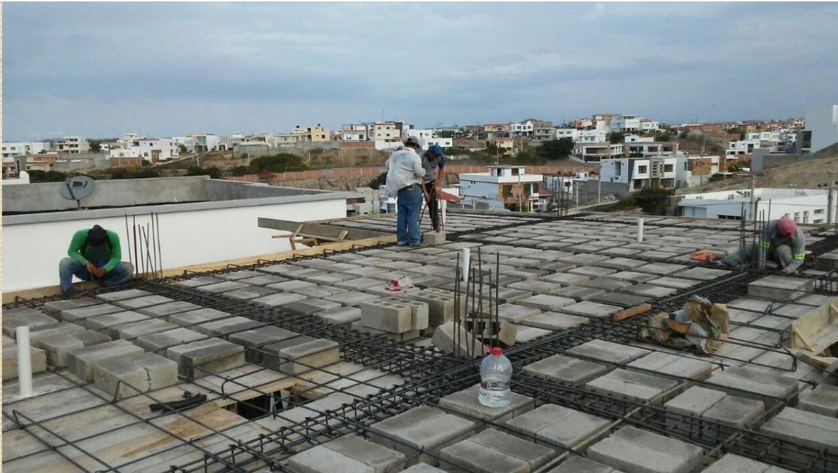
Gráfico No. 27. Armado de vigas en losa de cubierta. Vivienda Familia Vélez - Moreira. (2019).
