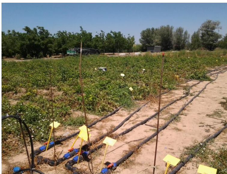
Foto 3. Portalaterales y llaves de riego (manuales).
