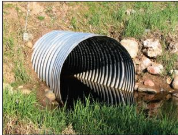
Ilustración 1-3 - ODT circular de metal corrugado
