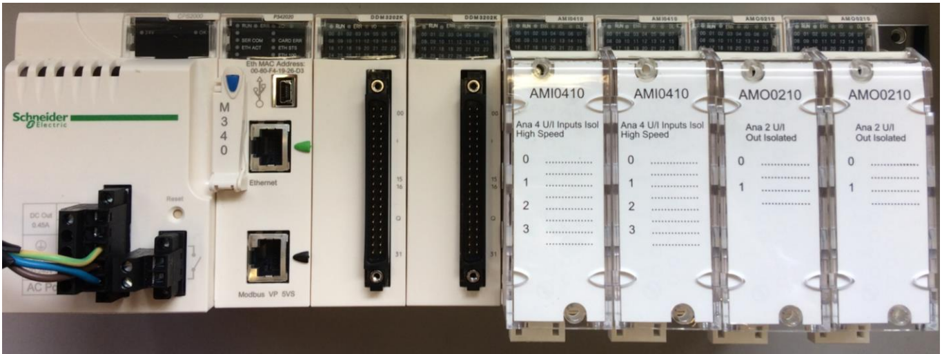
29 Vista general del autómata M340
