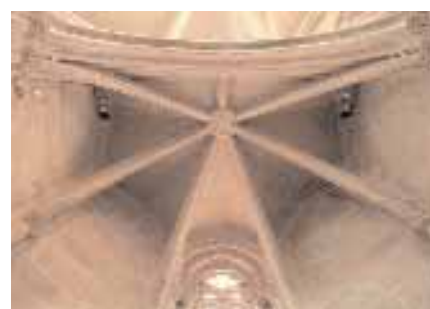
Fig. 1: Vista cenital de la capilla de la iglesia de Sant Mateu. Fuente: Propia
