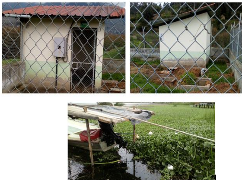
Figura 20. Estación de bombeo de aguas servidas que desembocan en el Lago San Pablo (Desaguadero)
