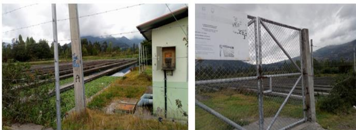
Figura 19. Planta de tratamiento de agua residuales sin funcionamiento que estaba prevista para beneficiar a parroquias como Eugenio Espejo, San Rafael, San Pablo de Lago, González Suárez y Jordán Concomitantemente, se ha observado la presencia de tuberías de alcantarillado en el Desaguadero por medio de las que se descarga aguas servidas de las parroquias aledañas y la implementación de una
