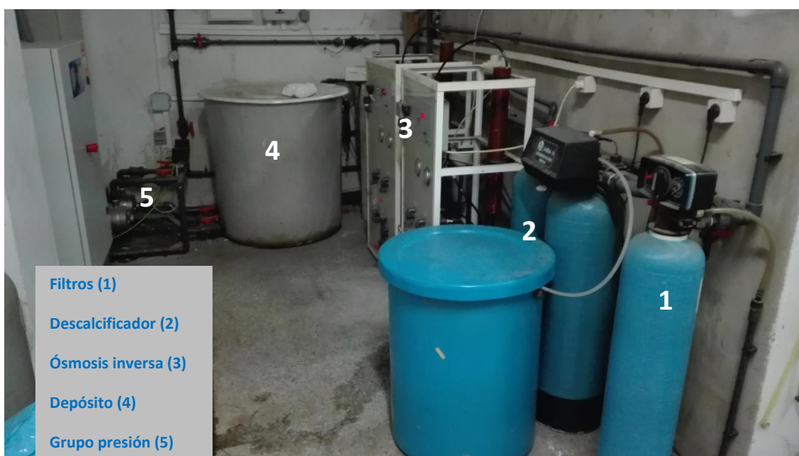
Figura 14.- Fotografía de la estación de tratamiento de agua situada en la planta baja de la Facultad de Farmacia.
