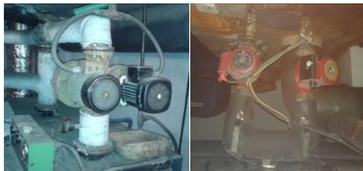
Figura 2.4. Bombas circuito primario y secundario.
