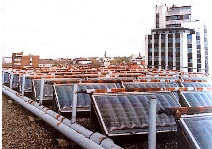
Figura 6.7. Campo de captadores con fuerte corrosión del lado exterior del recubrimiento de acero galvanizado.
