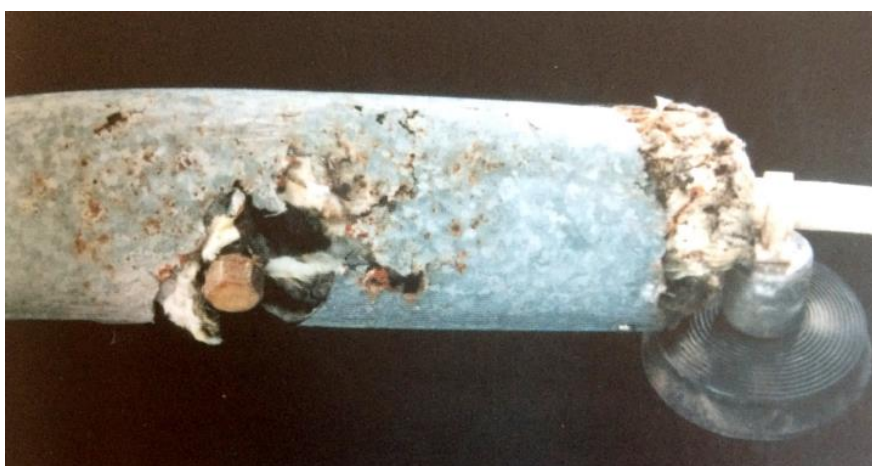
Figura 6.8. Daño corrosivo en un recubrimiento de acero galvanizado.
