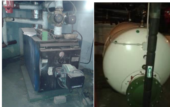
Figura 2.1. Caldera y acumulador solar existentes.
