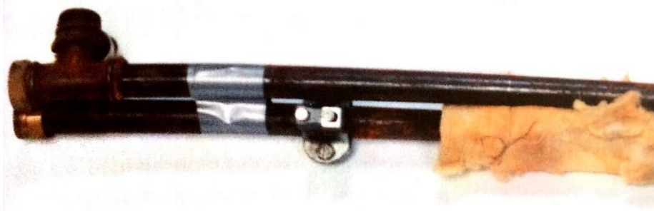
Figura 6.4. Superficie exterior de tubos de acero de un circuito primario.
