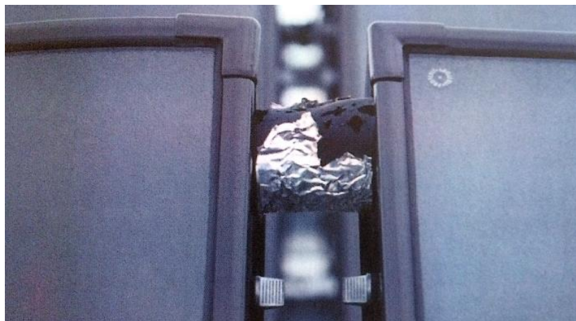
Figura 6.6. Daño en el aislamiento térmico sin recubrimiento causado por aves.
