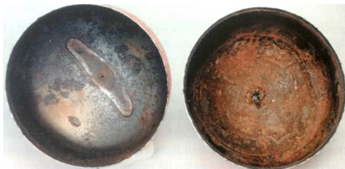
Figura 6.13. Aspecto de un vaso de expansión al cabo de 16 años de servicio.
