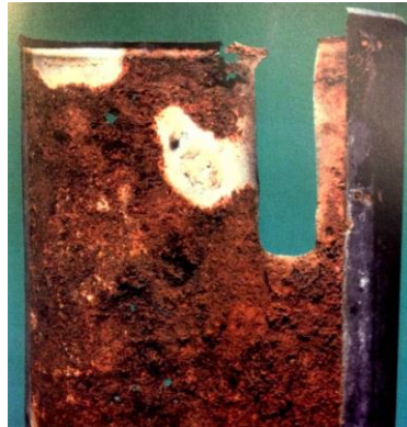
Figura 6.9. Daño corrosivo en el lado interior de un recubrimiento de acero galvanizado.
