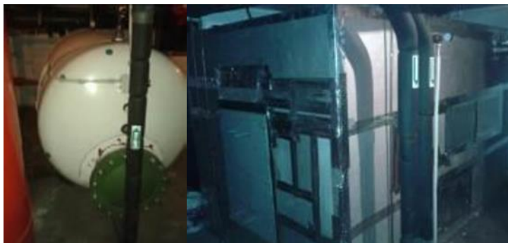
Figura 2.5. Acumuladores de suministro y solar.
