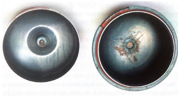
Figura 6.12. Aspecto de un vaso de expansión al cabo de 13 años de servicio.
