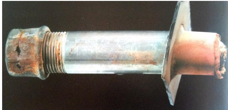
Figura 6.5. Daño corrosivo en el punto de contacto de diferentes metales.
