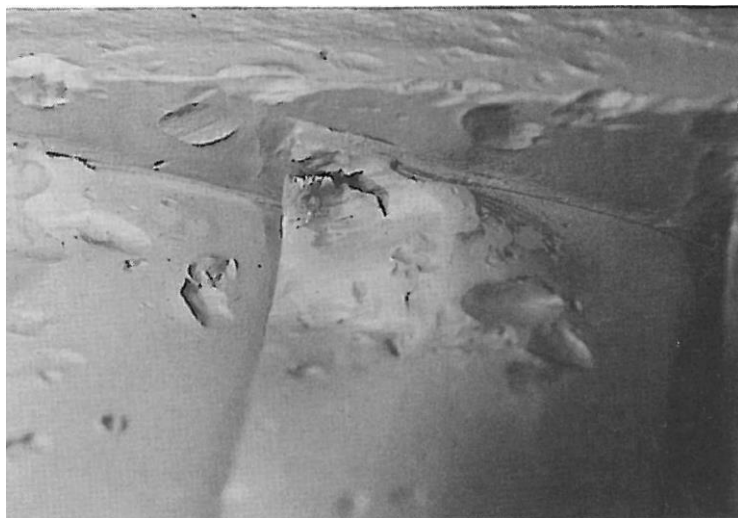
Figura 2.2 Daño por impacto en álabes del estator
