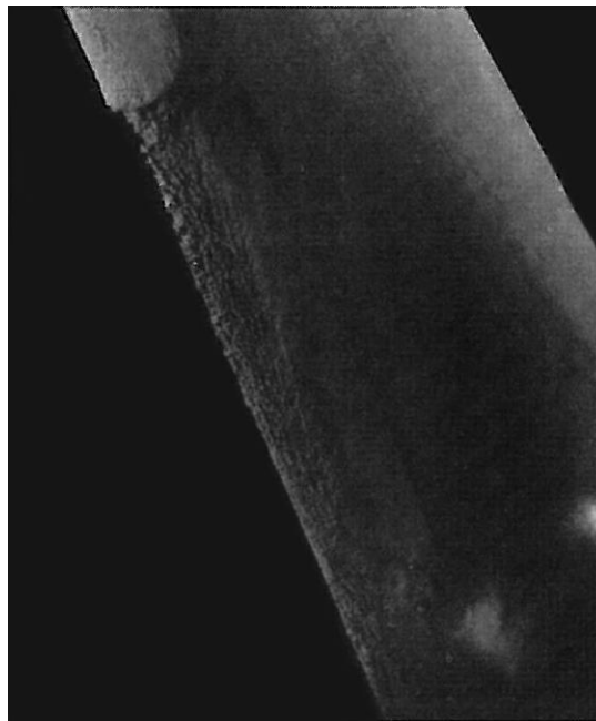
Figura 4.13 Erosión por debajo de la protección contra erosión
