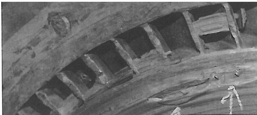
Figura 2.35 Daño por fricción causado por un objeto desconocido
