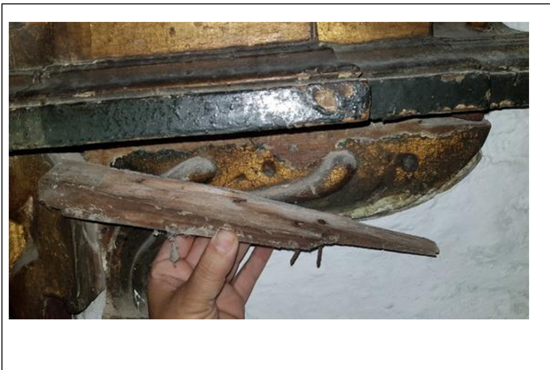
Fig.25. Piezas completamente sueltas
