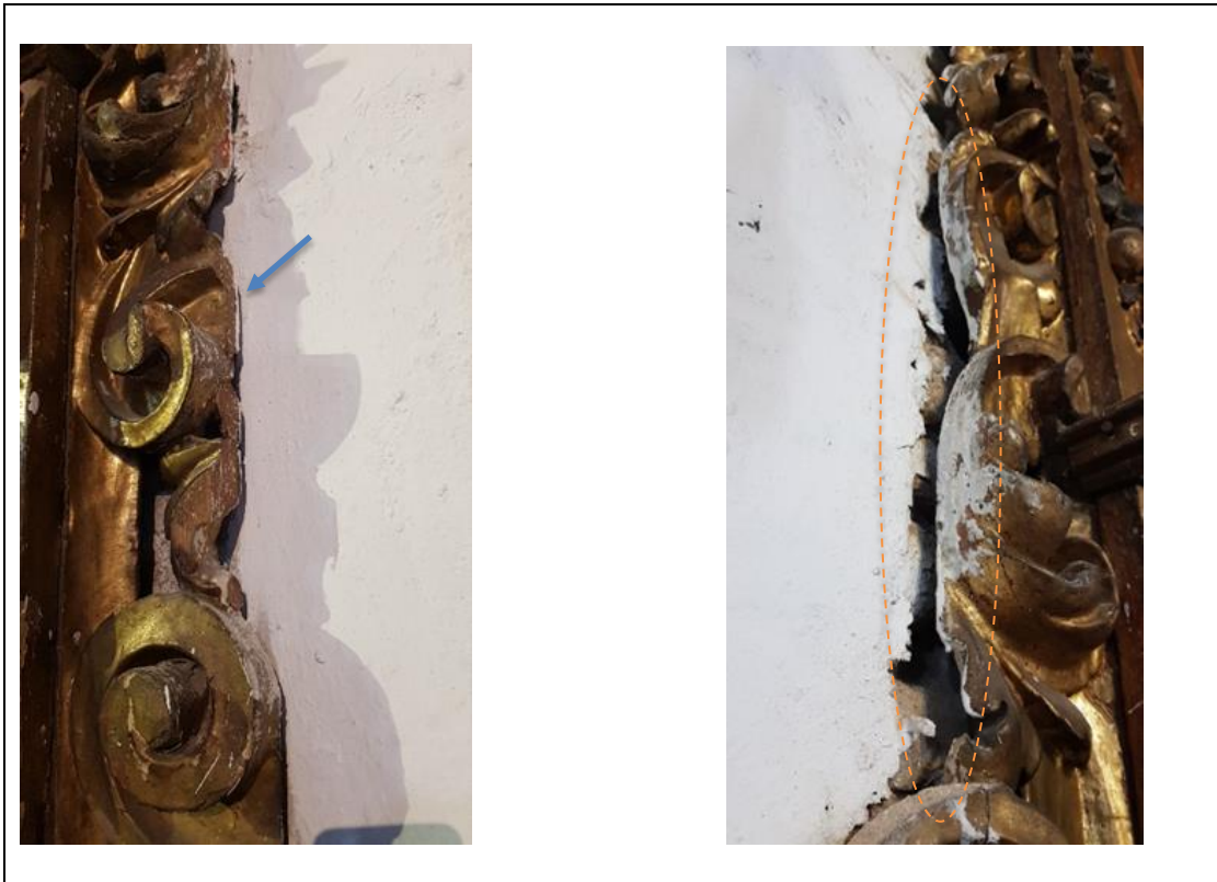
Fig.9, 10. Vista separación del retablo al muro
