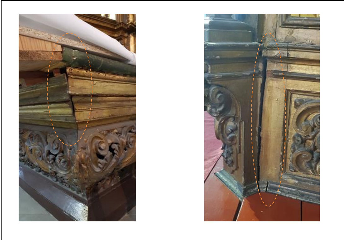
Fig.20, 21. Grieta estructural en sotobanco y desplazamiento, con inclinación hacia delante.
