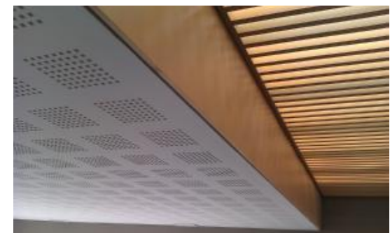
Fig. 18. Revestimiento acústico en techo
