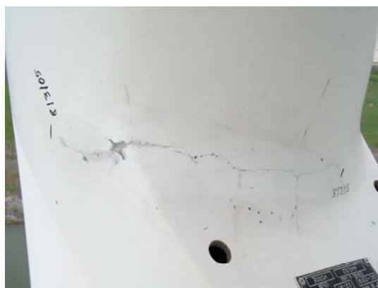
Figura 1.- Localización de las fisuras encontradas.
