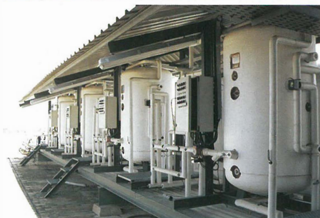
Figura 5. Banco de ensayos de equipos solares térmicos domésticos
