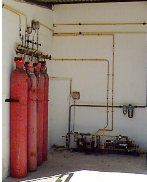
Figura 34: Grupo de bombeo de hidrógeno y rampa de llenado de gas a presión
