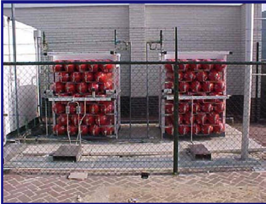
Figura 9: Instalación de almacenamiento de hidrógeno en botellas
