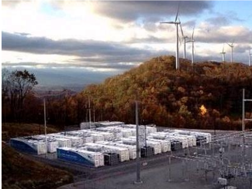
Figura 2: Parque eólico con almacenamiento en baterías. Fuente: AES Wind Generation
