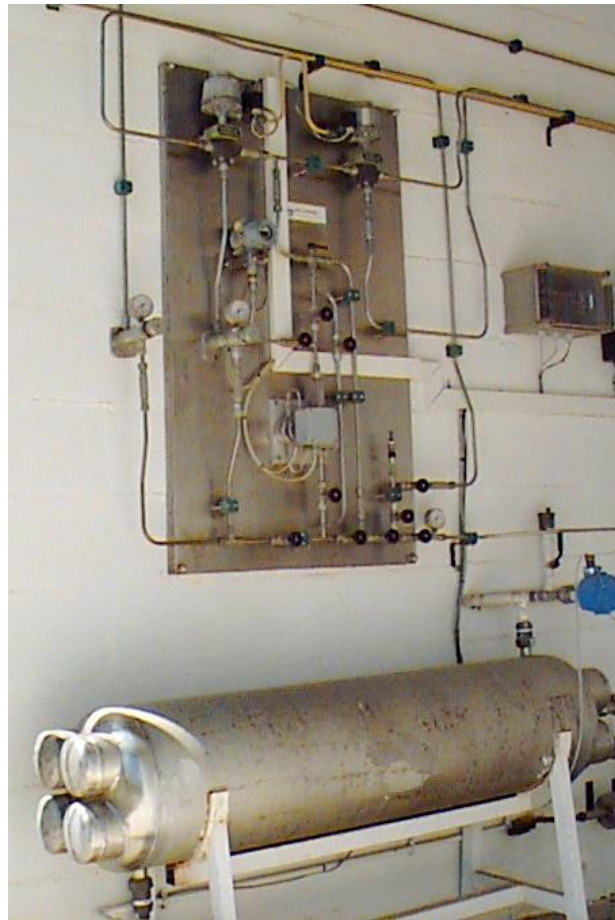
Figura 40: Contenedor de hidruros metálicos
