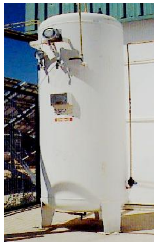
Figura 33: Depósito pulmón para almacenamiento en baja presión
