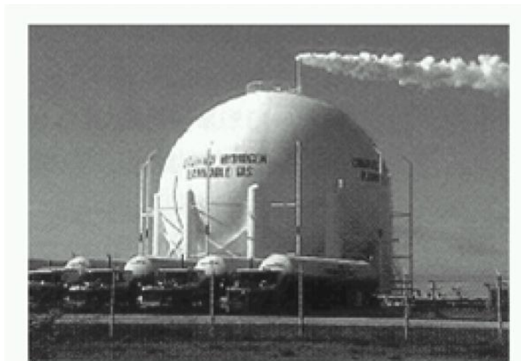
Figura 14: Depósito criogénico esférico de almacenamiento de hidrógeno líquido
