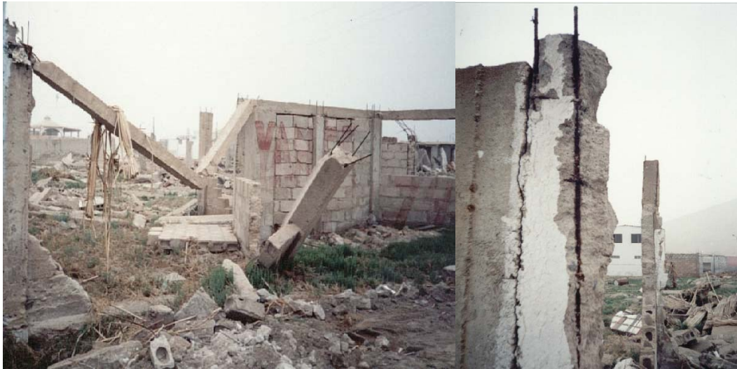
Figura 96. Estructuras de hormigón armado destruidas en Camaná, Perú. Foto: A. Melo.
