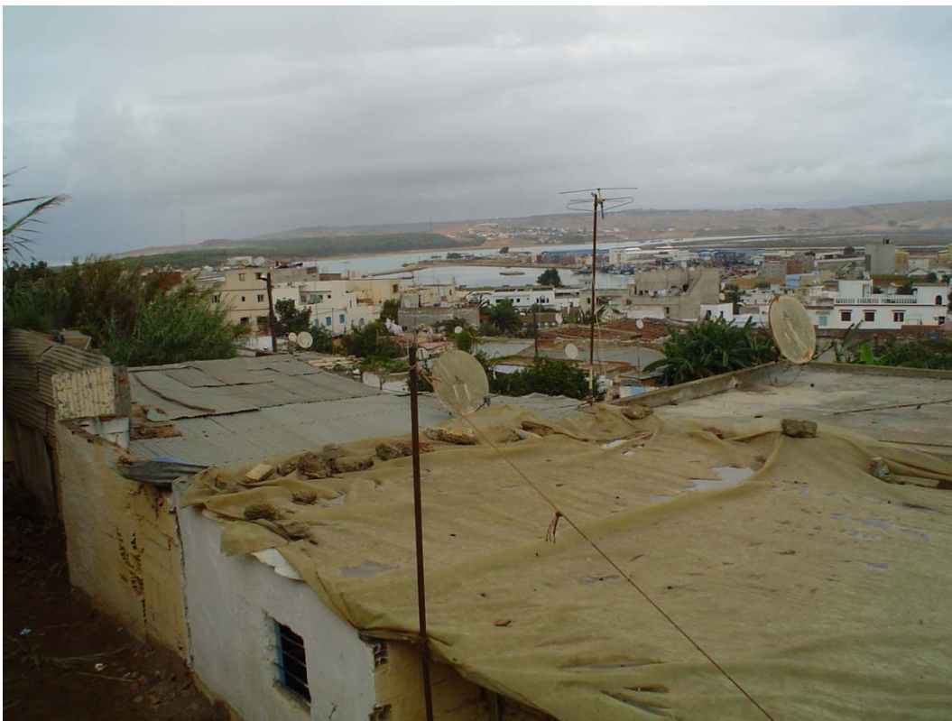
Figura 62. Estado previo de las cubiertas de las viviendas en el barrio. Foto: A. Melo
