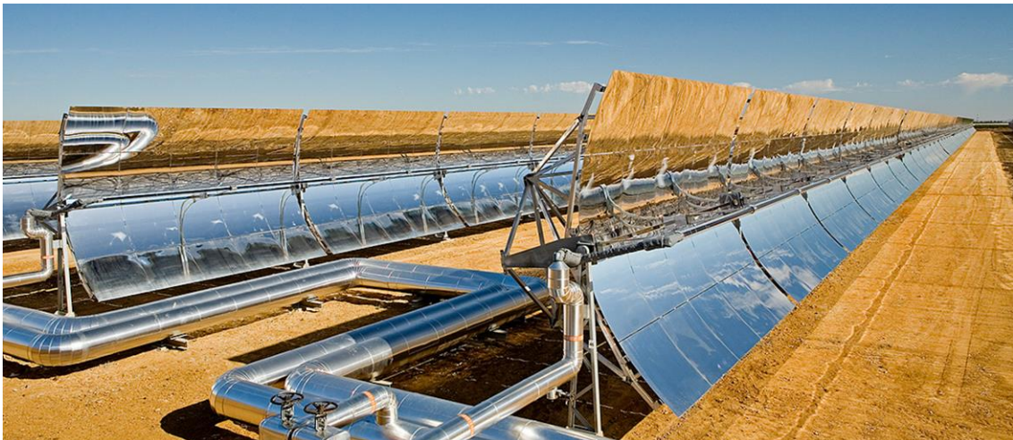
Ilustración 3. Colectores CCP (Acciona, 2009)
