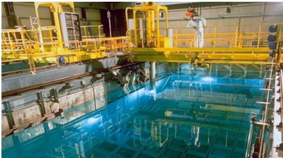
Figura 1: Piscina de almacenamiento de combustible nuclear gastado (Fuente: ENRESA).
