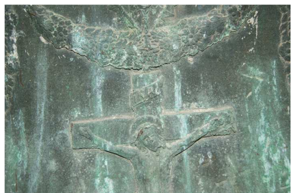
Fig. 3. Detalle de los relieves decorativos. Morfología de patologías en escorrentía.
