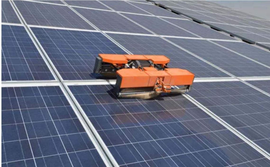
Figura 20. Limpieza mediante robots. Fuente: diariorenovables.com
