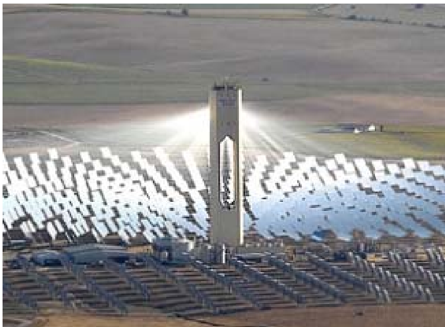
Figura 1. Campo de heliostatos con torre central. Fuente: energiayrenovable.es
