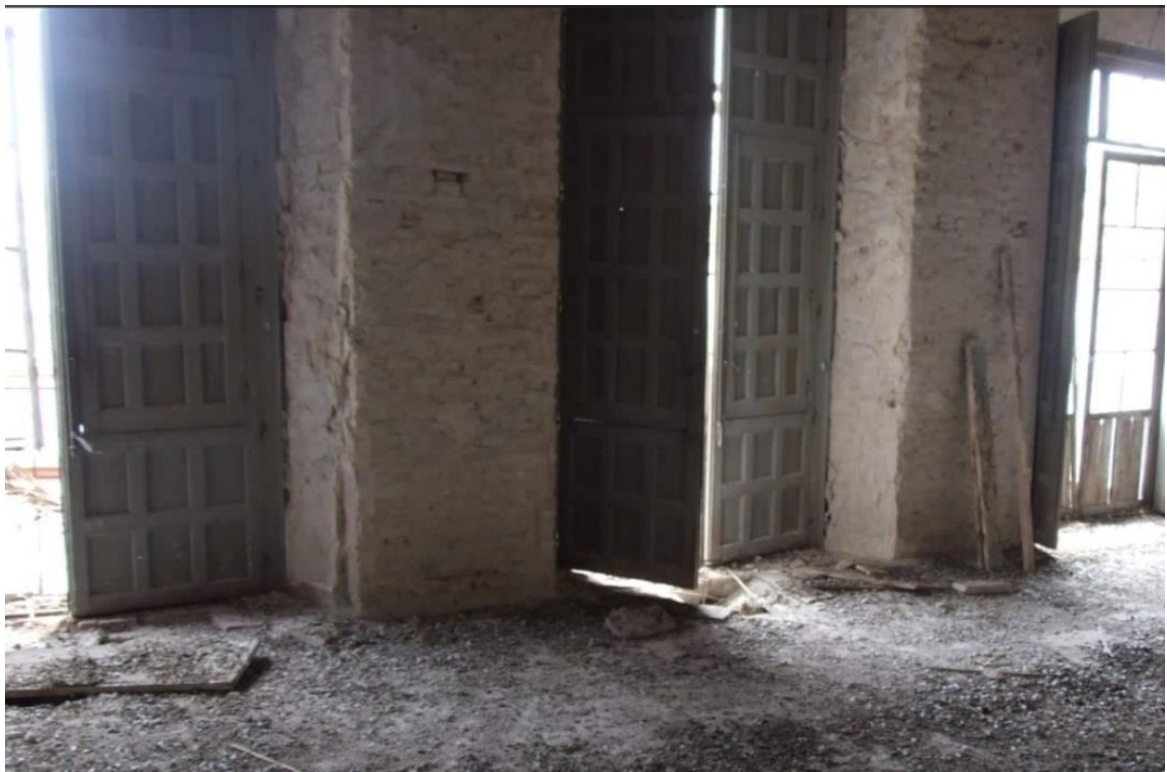
Figura 19.7. Detalles del estado de las estancias interiores del palacio 31
