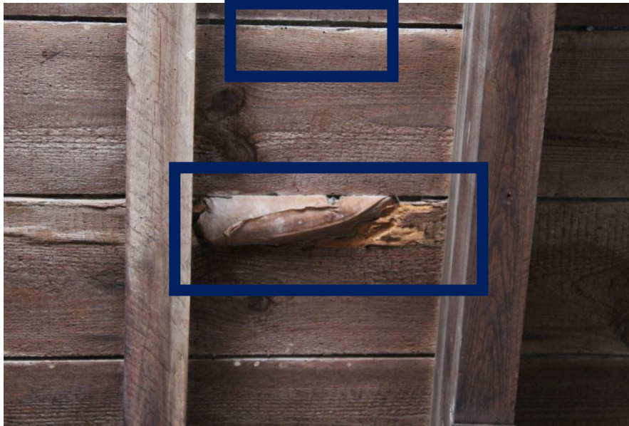
Imagen nº 7 Muñoz, C. (2015), artesanado de madera, se detectan agujeros de xilófagos y daños. Archivo Municipal de Utrera
