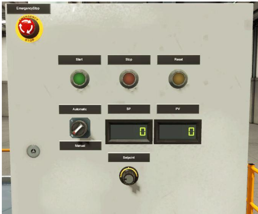
Figura 7. Panel de Control de la planta Control de Nivel
