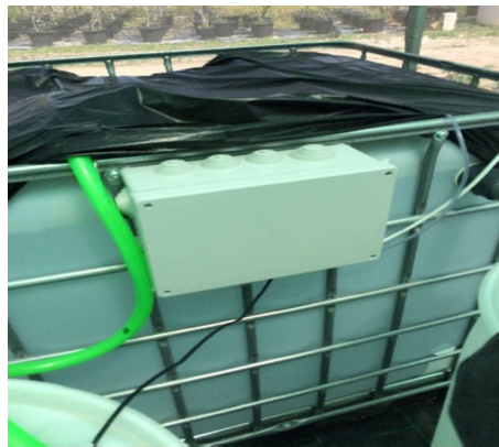
Ilustración 21. Caja de electricidad ubicada en tanque de peces.
