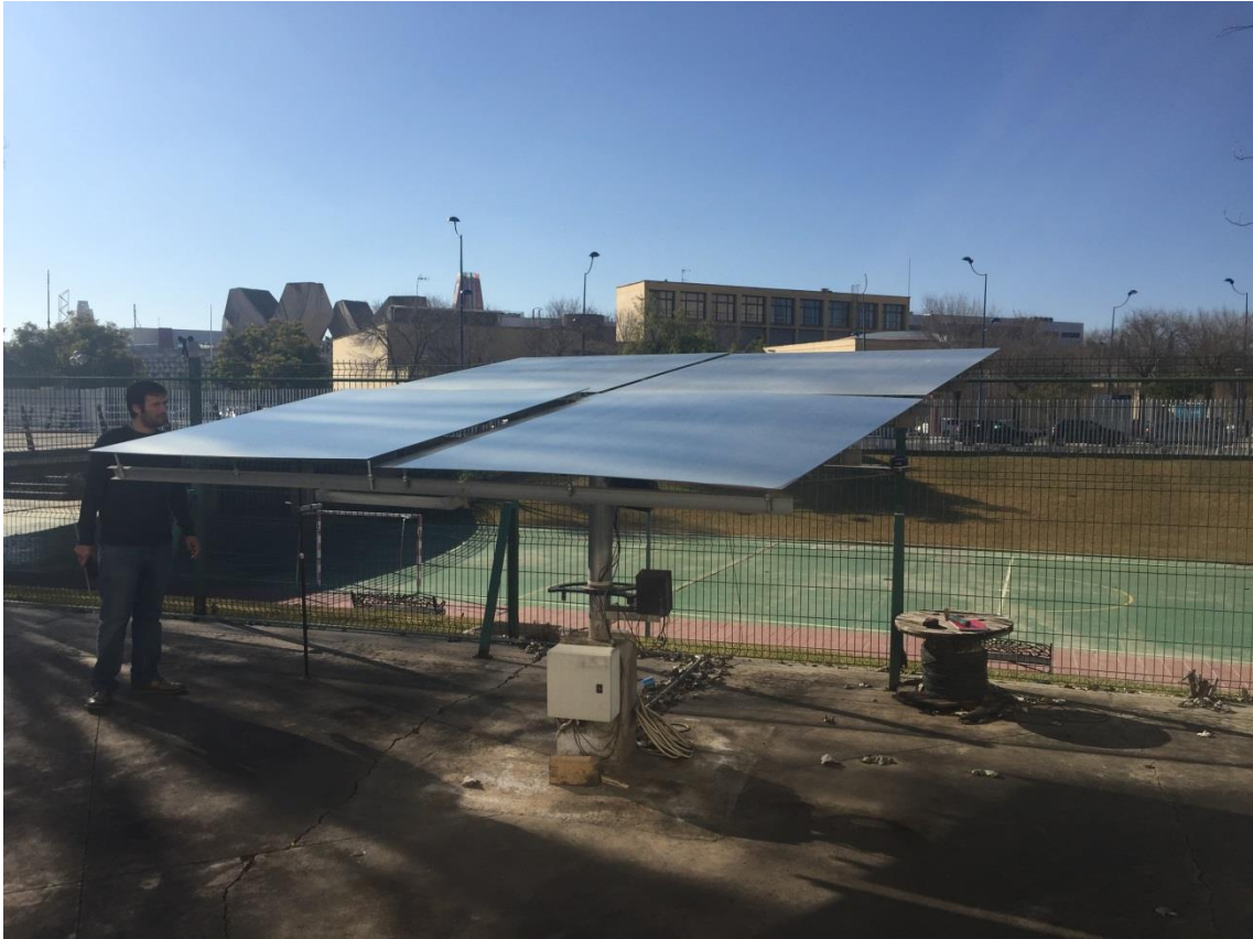
Figura 19. Heliostato actualmente instalado en la ETSI 2
