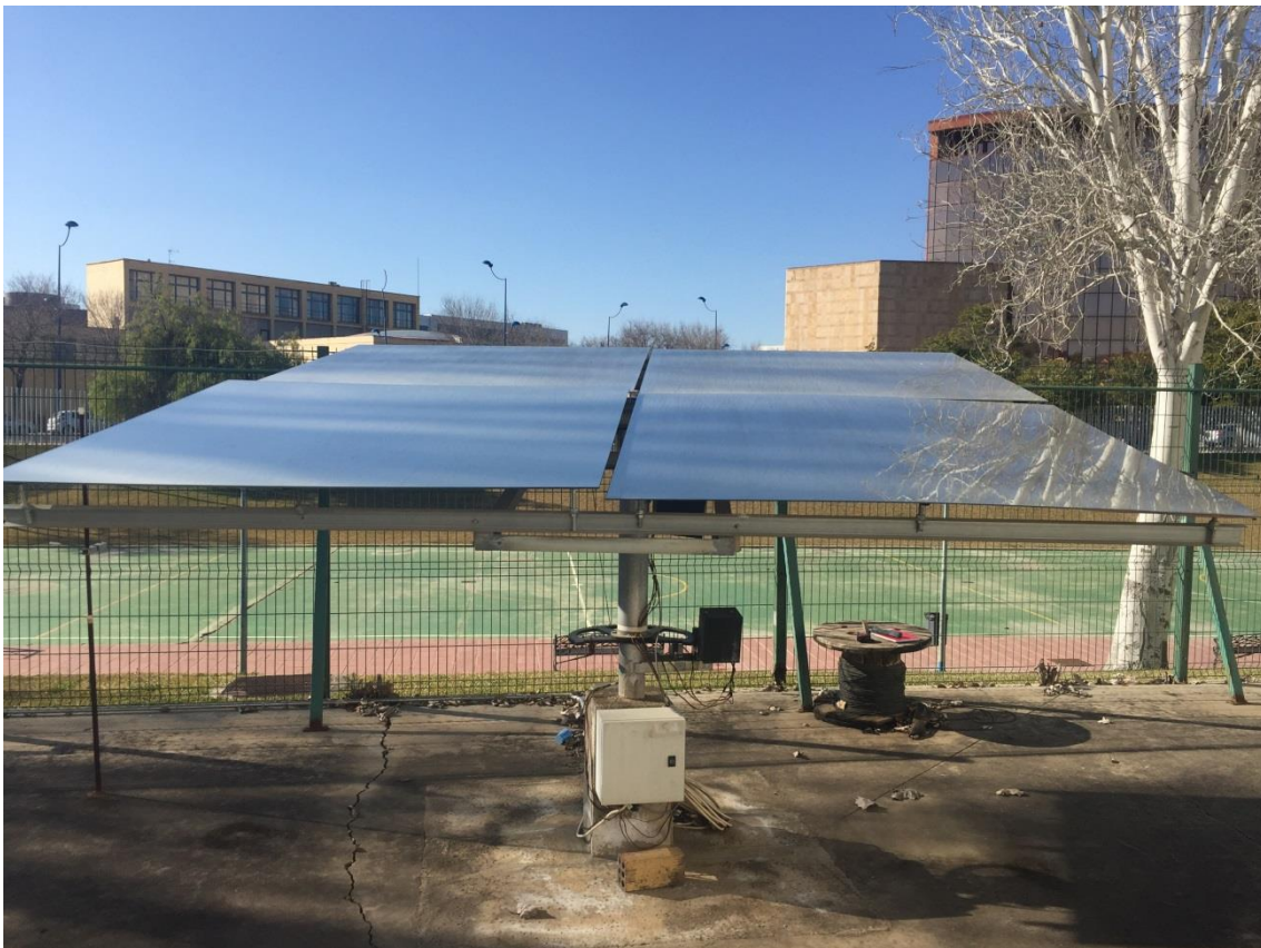
Figura 18. Heliostato actualmente instalado en la ETSI 1
