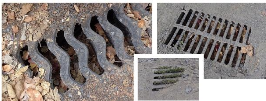
Fig. 6 Imbornales en La Canaleta .
