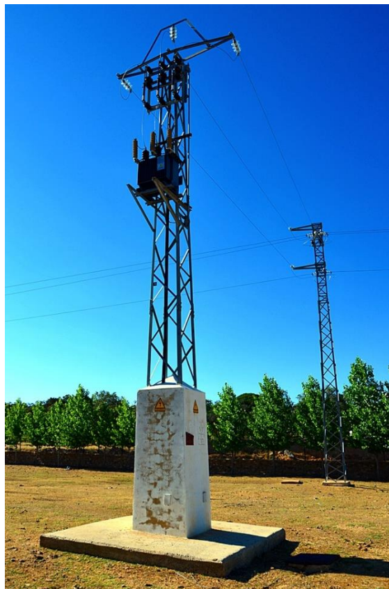
Figura 5. Transformador de intemperie
