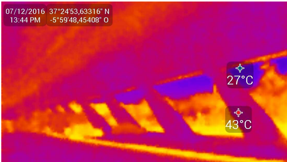
Ilustración 103. Termografía de la parte inferior del viaducto (3)
