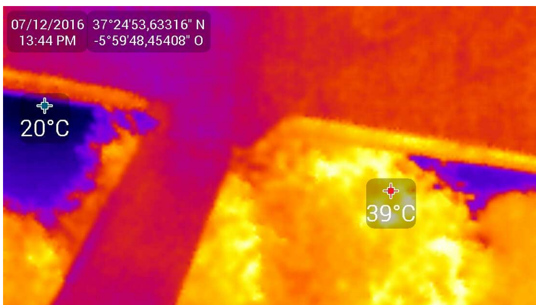
Ilustración 102. Termografía de la parte inferior del viaducto (2)
