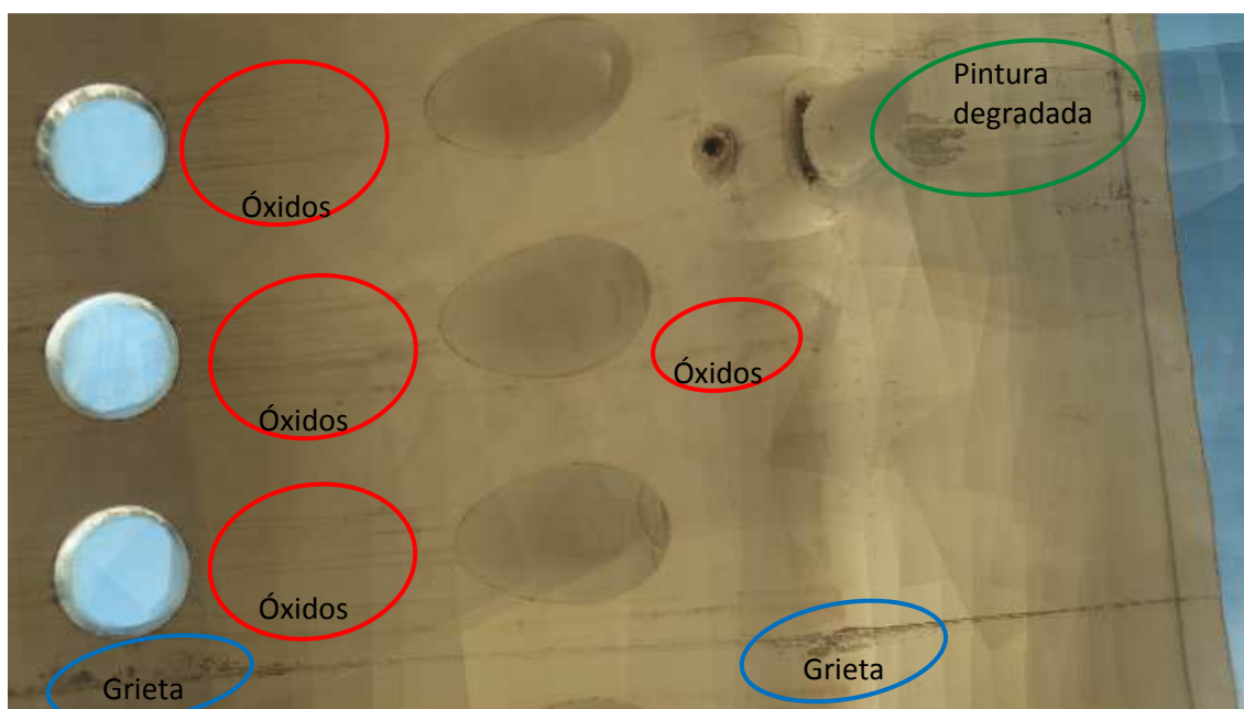
Ilustración 93. Patologías detectadas en el viaducto (2)
