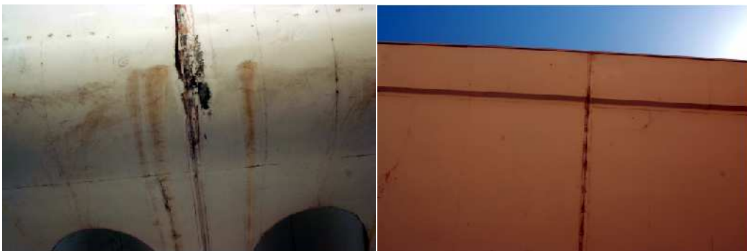
Ilustración 88. Zona intermedia curva y lateral plana de la parte inferior del viaducto
