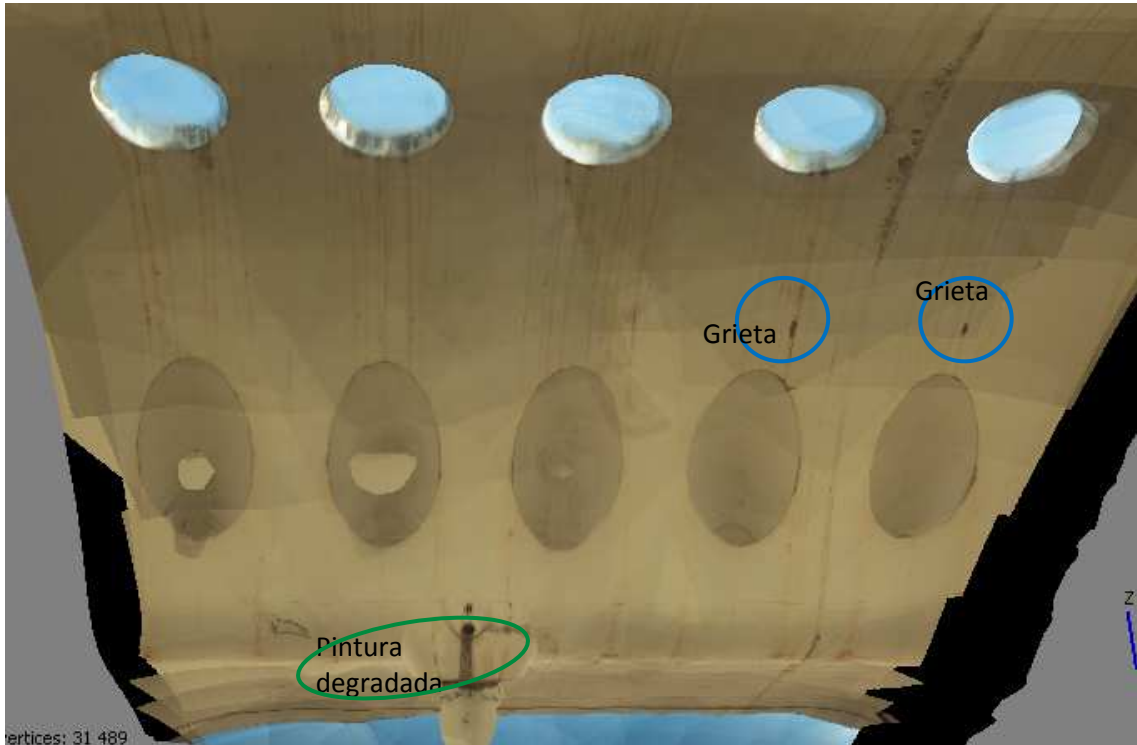
Ilustración 97. Patologías detectadas en el viaducto (6)
