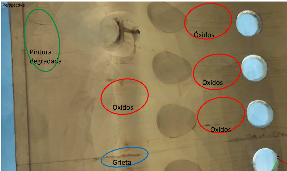
Ilustración 94. Patologías detectadas en el viaducto (3)
