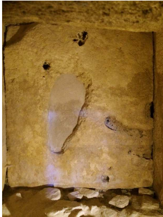
Figura 3.3. Apertura realizada por saqueadores actualmente tapada. Fuente: Elaboración propia. 29/10/2016
