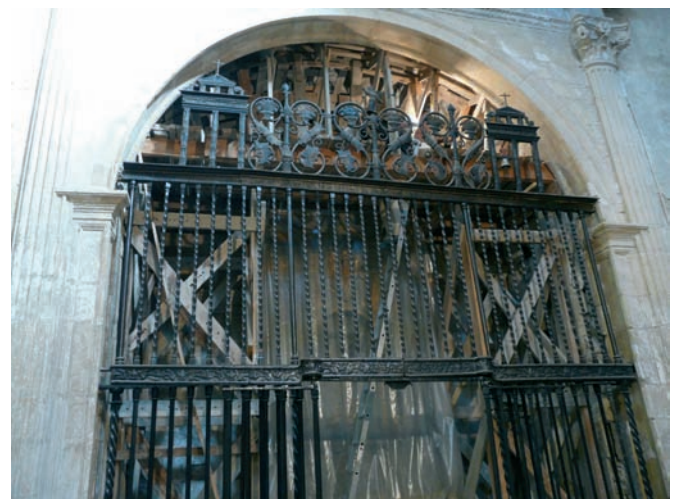
Fig. 4. Vista de capilla de la Antigua desde la iglesia y el apuntalamiento interior (2009)
