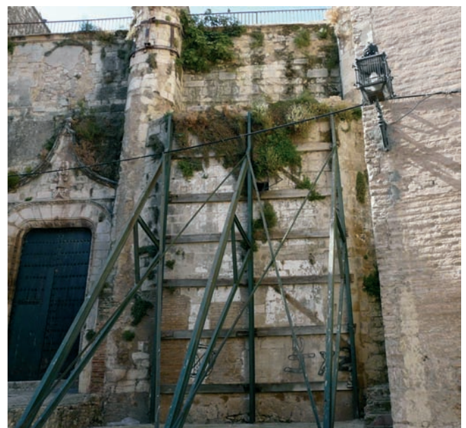
Fig. 2. Vista de fachada norte de San Miguel y los apuntalamientos de la capilla (2009)
