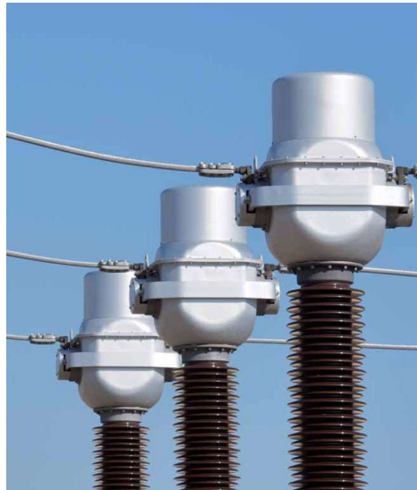
Figura 15 Transformador de medida en subestación
