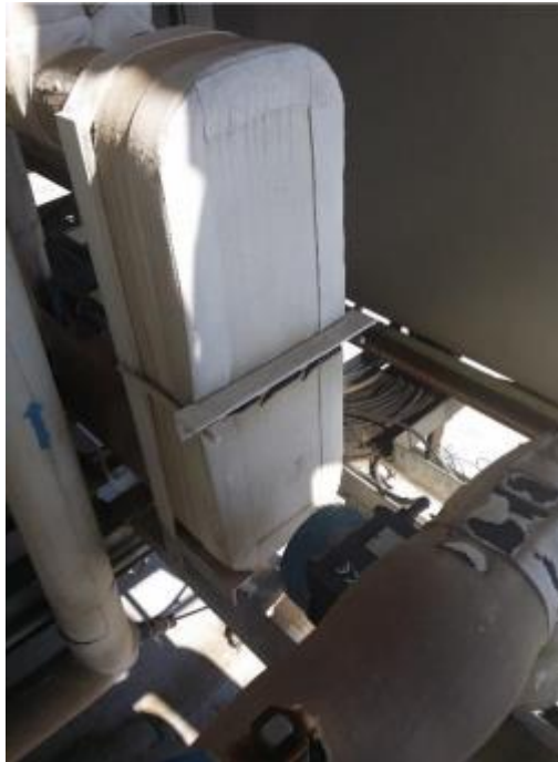
Figura 1-10. Intercambiador de calor.
