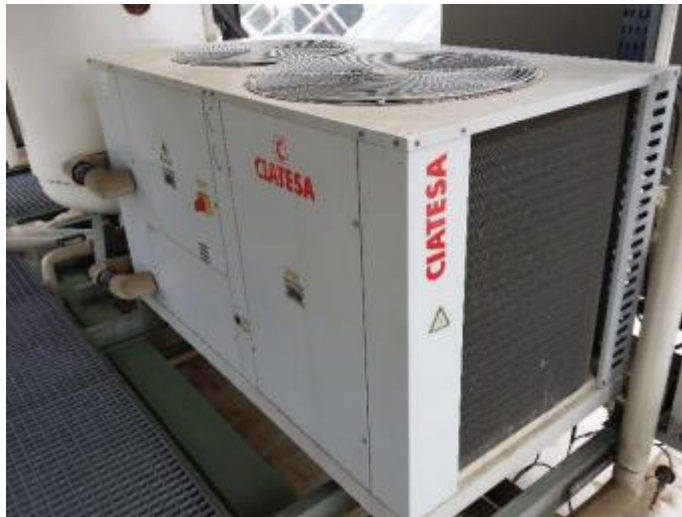
Figura 1-9. Bomba de calor.
