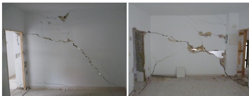
Figura 6.16. Estado tabiquería interior planta baja (Ferreira, 2016)
