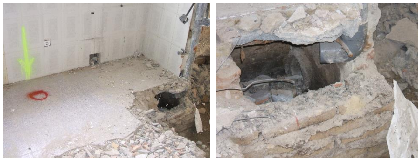
Figura 6.12. Arqueta y colector de la red de saneamiento
