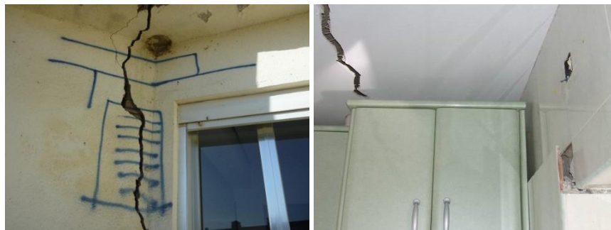
Figura 6.13. Grietas y desplazamiento muro de carga (Ferreira, 2016)
