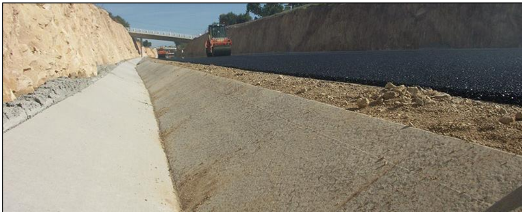
Ilustración 7 Cuneta revestida de hormigón para el drenaje longitudinal
