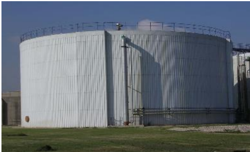
Ilustración 36 Digestor de EDAR
