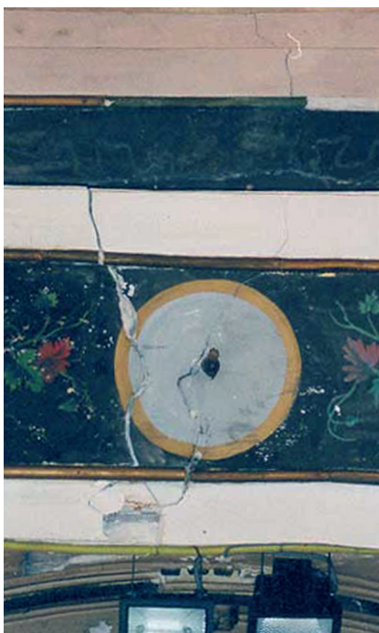
Detalle de la rotura de un arco fajón de la bóveda. Se observa el antiguo gancho de sujeción de las lámparas; el taladro servirá para introducir los tirantes de cuélgue de la bóveda.
