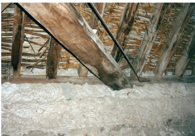
Vista de un cuadrado de la armadura de madera del presbiterio; se observa que lo acompaña un tirante metálico de una reparación anterior.
