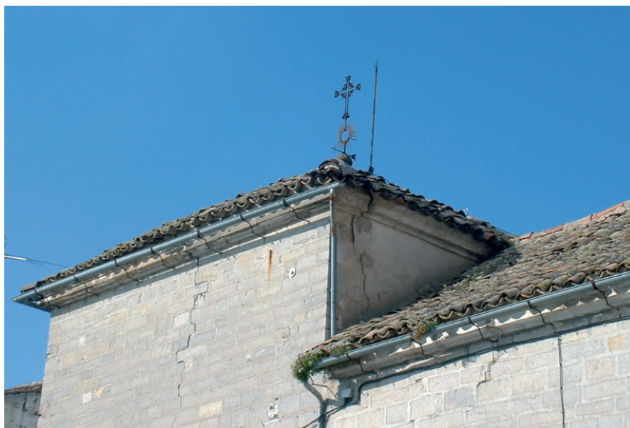
Vista de las paredes exteriores del presbiterio. En las paredes traseras se observa que existe todavía el revoco original de cal, protegiendo así las piedras de los muros, por lo que no se eliminará, sino que consolidará, restaurará y conservará adecuadamente.
