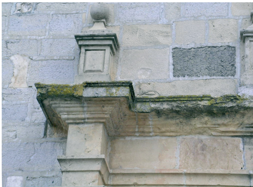
Vista del deterioro actual de molduras con pérdidas de material pétreo del entablamento de la portada que, al dejar de actuar como goterón, provoca graves deterioros en la superficie de piedra, por lo que en este caso la reposición de la materia de piedra perdida está justificada al resolver un problema patológico y constructivo.
