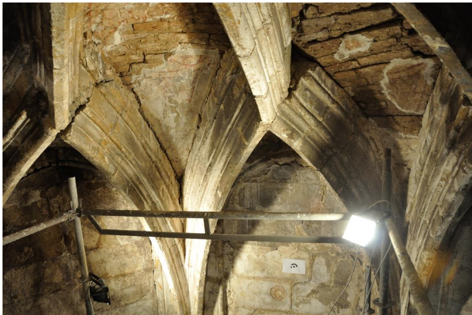
Figura 2-10 Pérdidas de material
