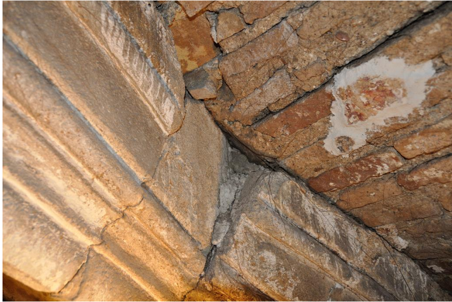
Figura 2-9 Daños en nervio y plementería
