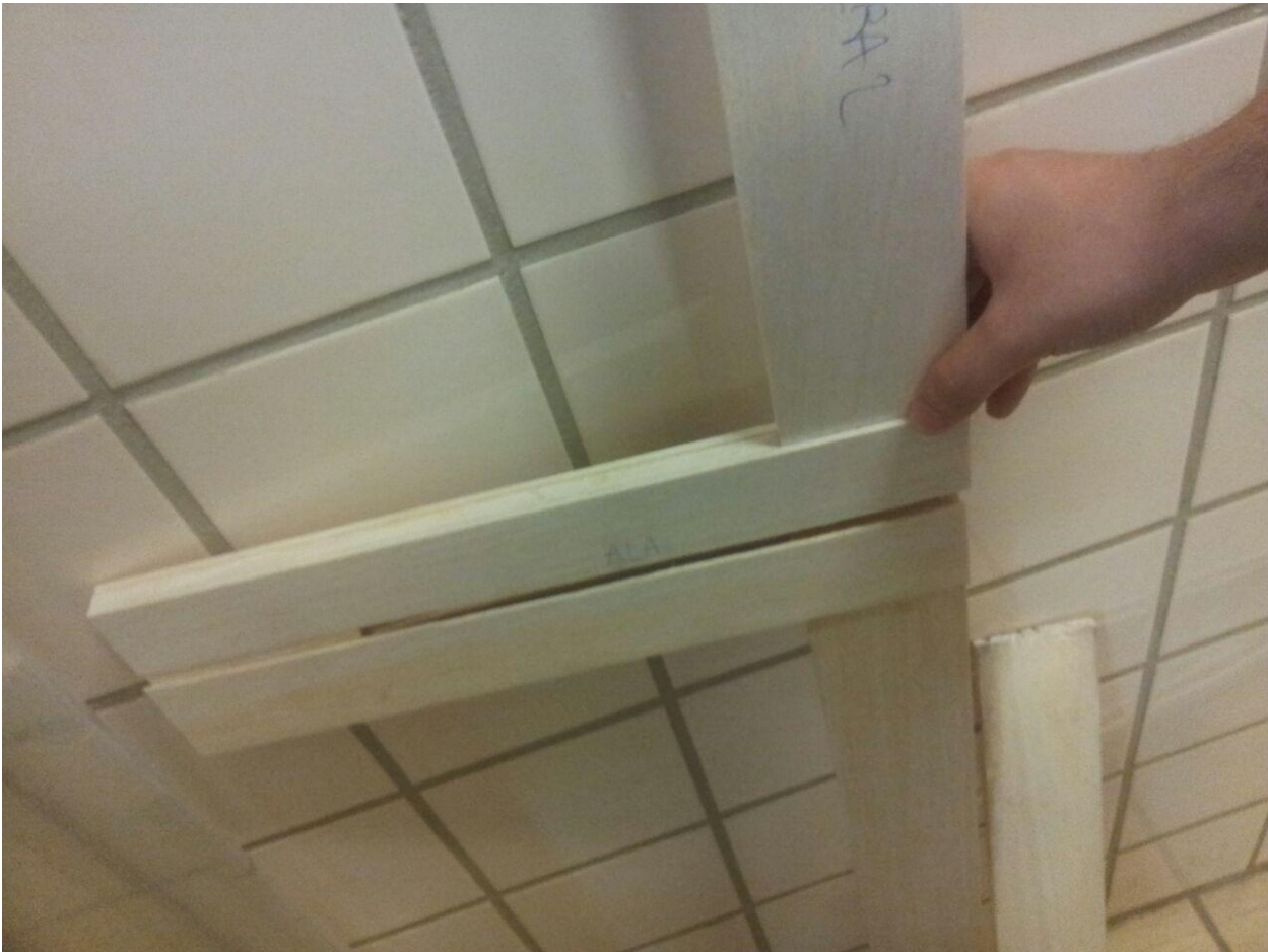
Fig 3.13 Rotura del largero principal y ala.
