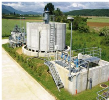
Fig.6. EDAR con lecho bacteriano en Bermeo (Vizcaya). (CEDEX, 2010)
