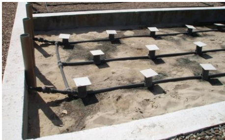
Fig.3. Filtro de arena en Planta Experimental de Carrión de los Céspedes (Sevilla). (aquaberri.com)
