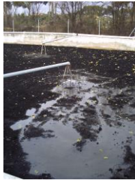
Fig.4. Filtro de turba en EDAR de Valdepeñas (Granada). (Valdepeñas.es, 2015)
