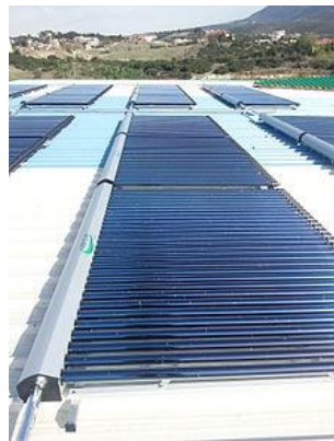
Fig.5. Captador solar de tubos de vacío con tubo de cobre
