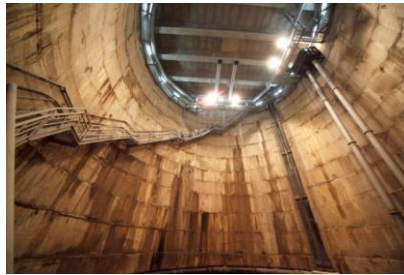
Fig.3. Tanque de tormentas en Alameda de Hércules (Sevilla). (Emasesa)
