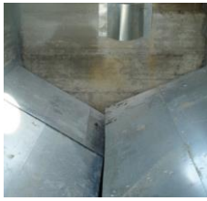
Fig.4. Interior de Tanque Imhoff. (CEDEX, 2010)
