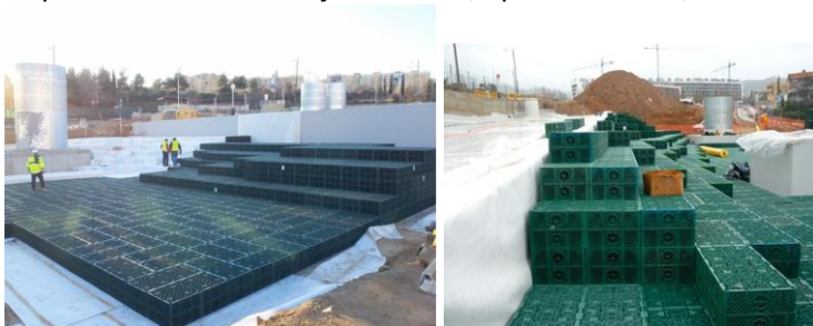
Fig.3 y 4. Depósito de infiltración subterráneo en Avda. Estatut. Barcelona. (ecohabitar.org) y (graf)
