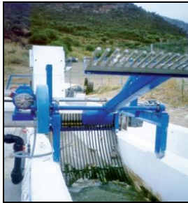
Fig.5. Reja de finos automática. (CEDEX, 2010)
