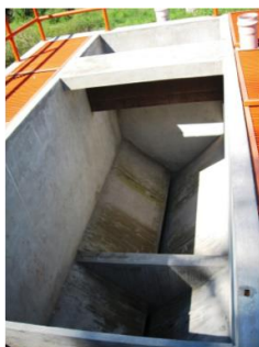
Fig.3. Tanque Imhoff en área rural de Perú ( www.flickr.com )
