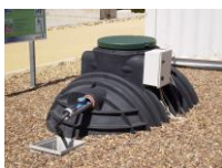
Fig.3. Sistema compacto en Hotel Solúcar. Sanlúcar la Mayor (Sevilla) (elaboración propia en CENTA)
