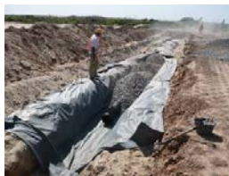
Fig.6. Drenaje con tubo en Zona Franca (Uruguay) (concret-nor.com, 2015)
