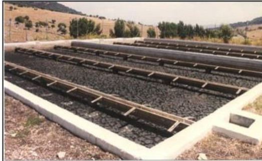
Fig.3. Vista general de un filtro de turba en Carrión de los Céspedes (Sevilla). (CEDEX, 2010)
