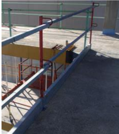
Figura 2–37. Barandilla de seguridad
