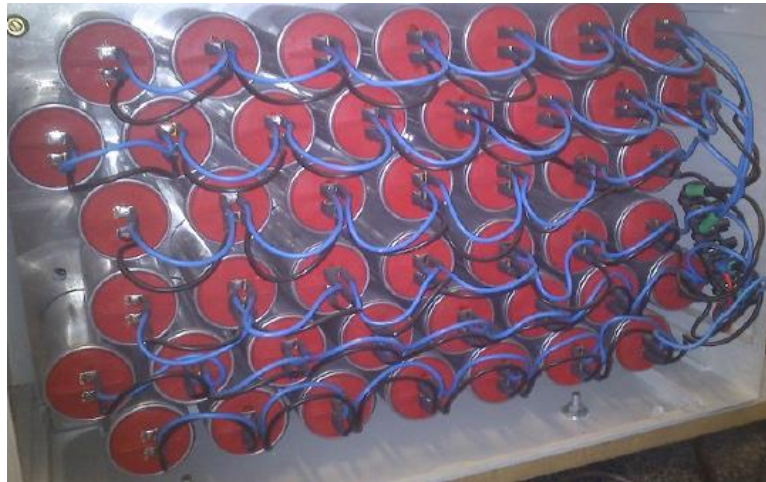
Figura 1-21. Banco de condensadores
