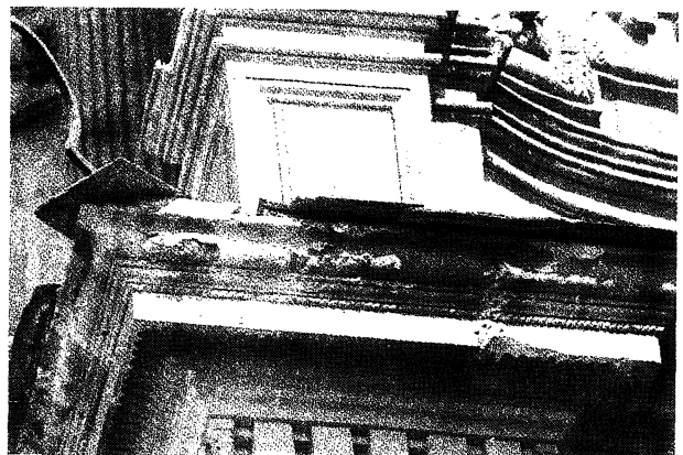
d) Disyunciones de películas y disgregaciones en las cornisas.
