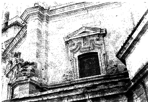
e) Fisura causada por cargas o por seísmos.
