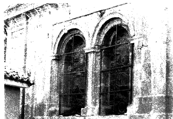
e) Pátinas oscuras en las ventanas con mallas metálicas.
