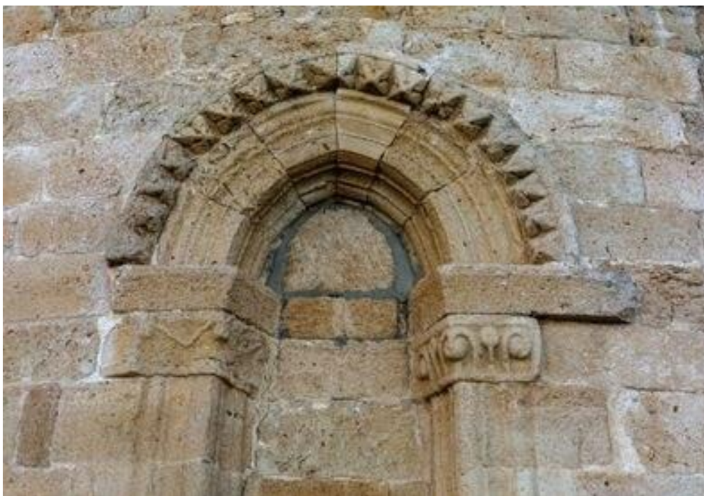
Figura 4: Intervención con cemento realizada en Santa María del Castrillo, Castronuño, Valladolid Fuente: Fotografía realizada por Javier Álvarez y extraída de https://elpais.com/cultura/2021-11-10/una-joya-del-romanico-castellano-queda-danada-por-un-misterioso-arreglo-con-cemento.html , 2021
