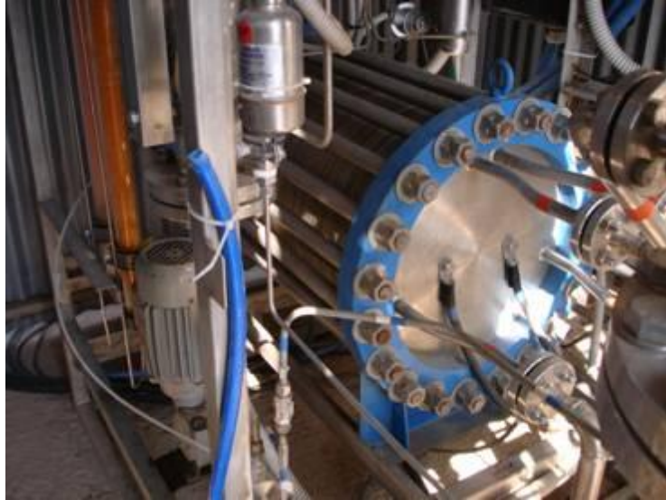
Figura 4.8: Detalle del stack del electrolizador.
