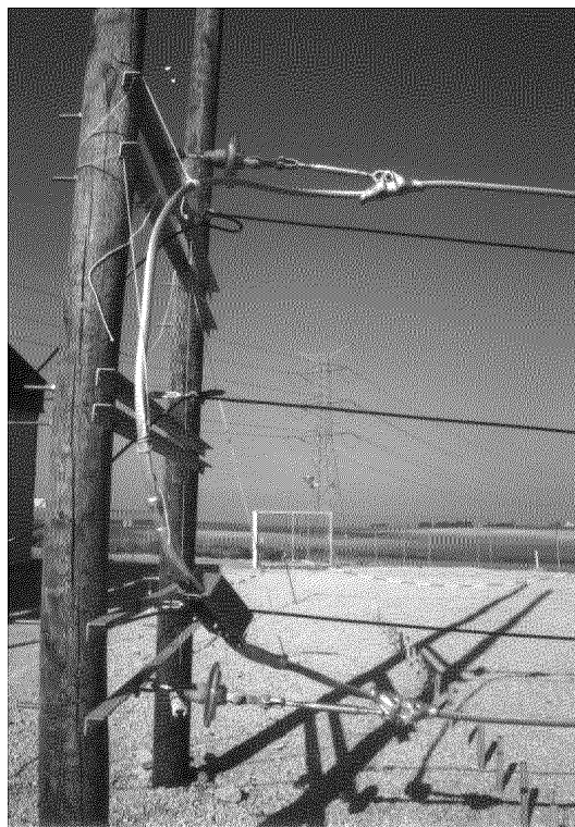
Figura 7.18: Extremo del vano y transformador de intensidad insertado en el lazo
