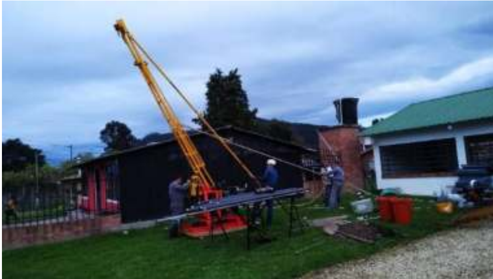
Figura 3.5. Equipo de perforación por rotopercusión (fuente propia)
