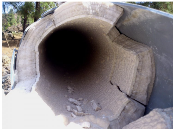
Figura 2.5 Sedimento acumulado en una tubería. Fuente: [3].
